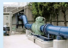
Conduit-type single turbine
