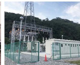
特高変電設備
