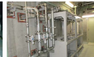
原子力発電所 新規制基準火災防護対策
