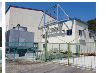
大電力試験設備の構築
