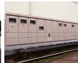
高圧受変電設備
