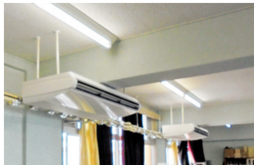
学校空調設備導入（室内機）
